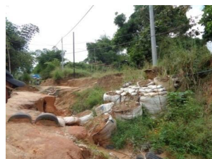
Fig.22 : Cas typique de menace des chutes de pylônes de la SNEL le long de la Route ravinée.
