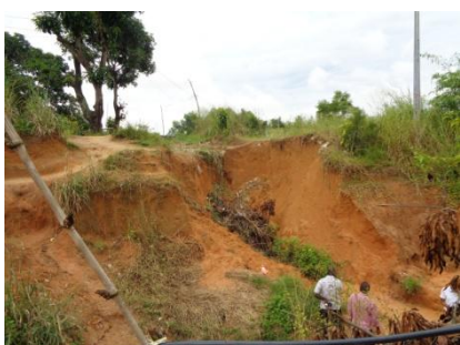
Fig.21 : Cas typique d'une érosion naissant au croisement d'une rue et de la Route principale.
