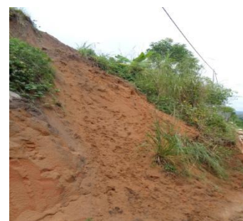
Fig.23 : Glissements de parois de ravins le long de la Route, Ici, preuve d'un sapement à la base et/ou de la présence d'argile
