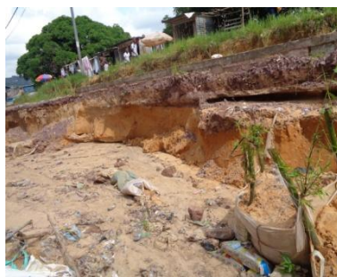
Fig.19 : Km5 : Echec des travaux entamés par une entreprise chinoise qui était chargée de refaire la route.
